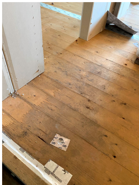
Abbildung A2: Brettsperrholzdecke mit Stockflecken
