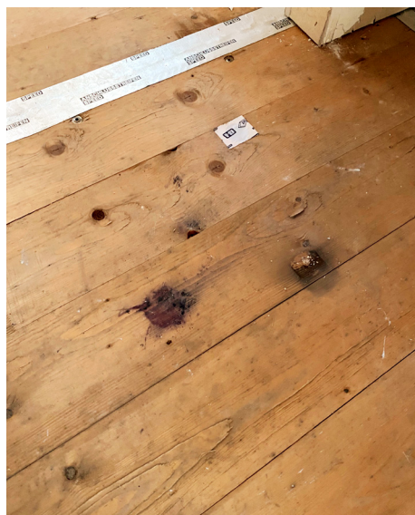
Abbildung A3: Holzverfärbende Pilze unterhalb einer temporären Abdichtung
